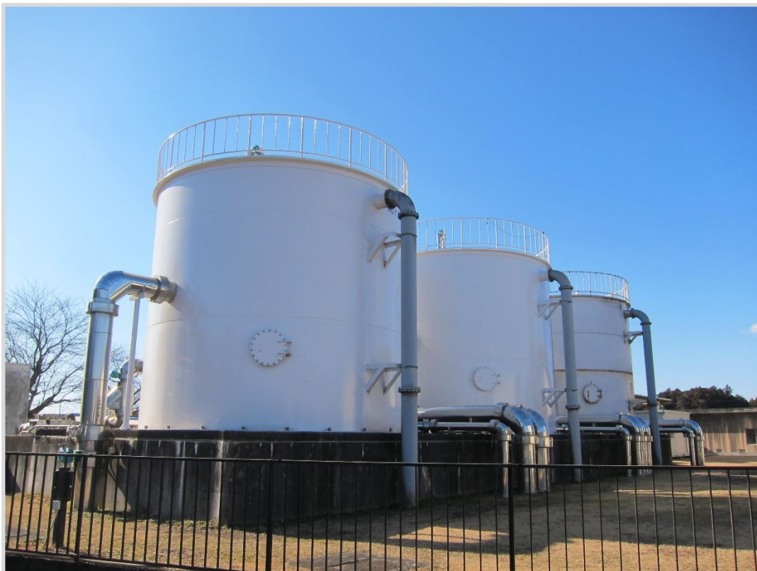
小川浄水場 急速ろ過器
