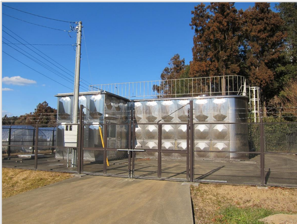
小川第2導水中継場
