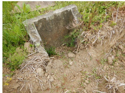
× 流出土で詰まった落水口
