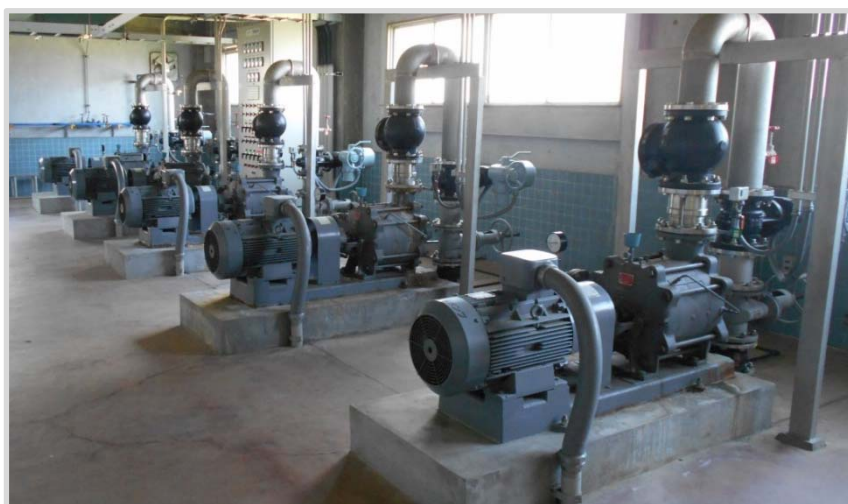
小川浄水場 配水ポンプ
