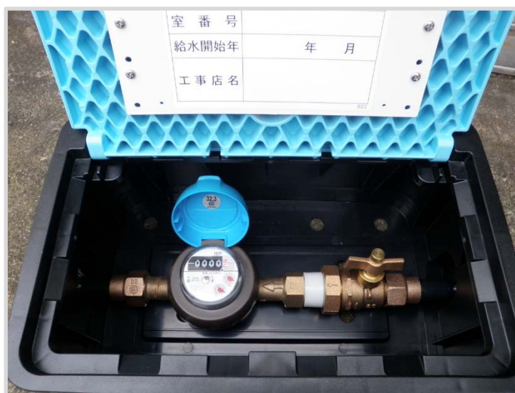
水道メーター
