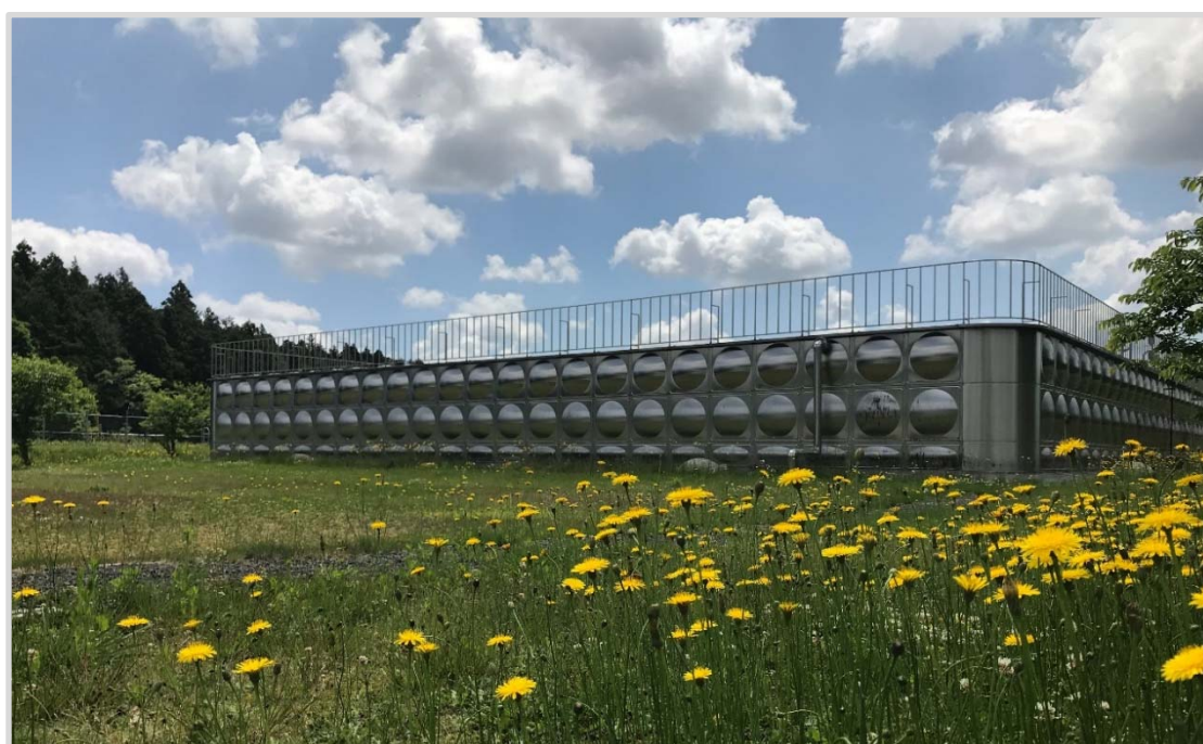
美野里浄水場 配水池 No2
