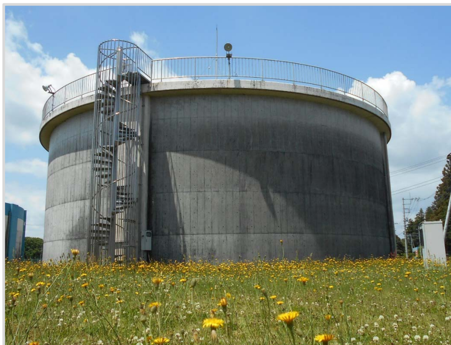
小川浄水場 配水池 No1
