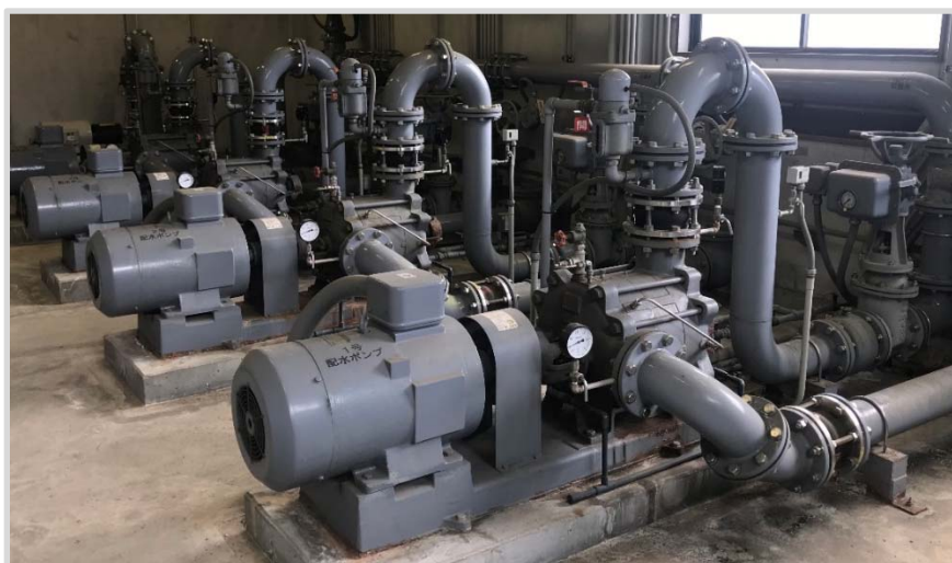
美野里浄水場 配水ポンプ
