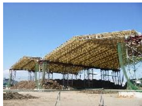
可燃物の貯留ヤード （宮城県石巻市、平成25年（2013年）6月）
