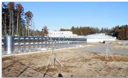
水道局の貯水タンク
